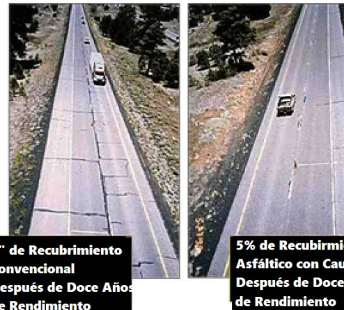
Secciones de prueba de AC convencional y AR situadas en la Sección de Prueba I-40 SHRP en Flagstaff, AZ, 1989.
